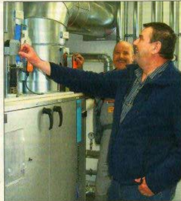
Handwerker waren in den vergangenen Wochen dabei, die Installation im neuen Hortgebäude zu durchzuführen.
